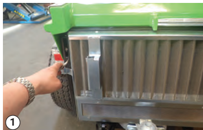
Demontáž krytu chladiče
